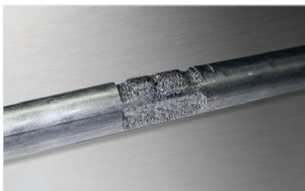
Spaltkorrosion unter einem üblichen Schellenkörper
